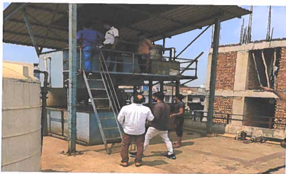
M/s Silkon Thread Pvt. Ltd. (Effluent Treatment Plant)
