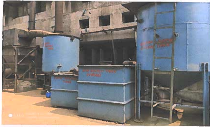
M/s Marc Sanitation Pvt. Ltd. (Effluent Treatment Plant)
